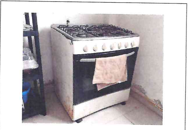
La mayoría de los equipos con los que actualmente se opera en el área de cocina se encuentran en malas condiciones, lo cual representa un riesgo tanto para el personal como para el adecuado manejo higiénico de los alimentos.
