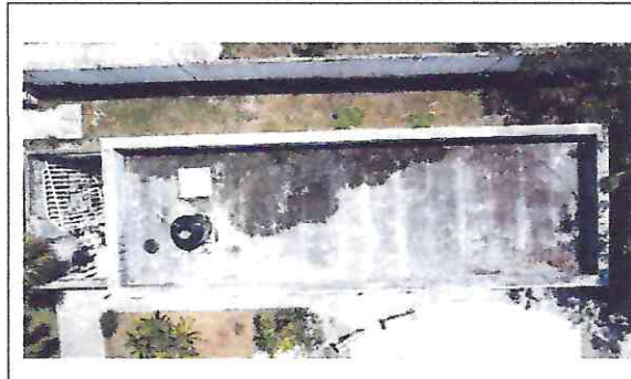
Calcreto de losa en mal estado
