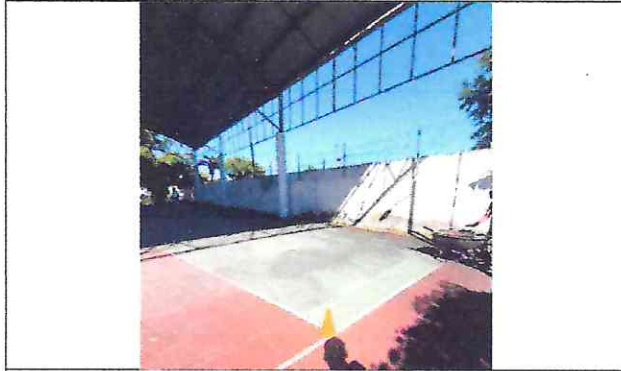
Domo con elementos estructurales en malas condiciones
