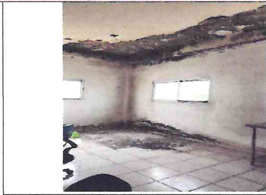
Filtración de humedad en muros y azotea
