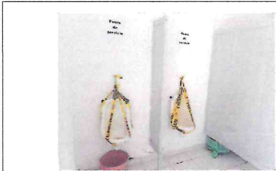
Núcleo sanitario en malas condiciones
