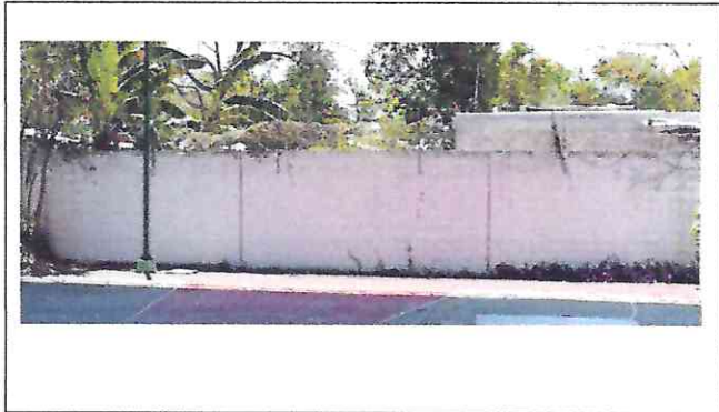
Barda colindante con deterioro estructural
